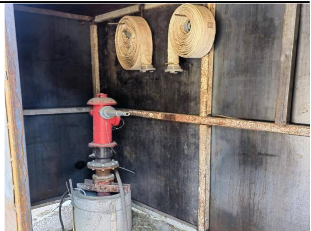
饲料堆放场设置专用消防水井
